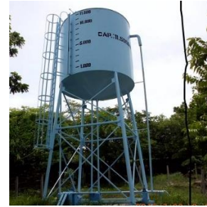
Fig. 8. Tanque metálico sobre torre
